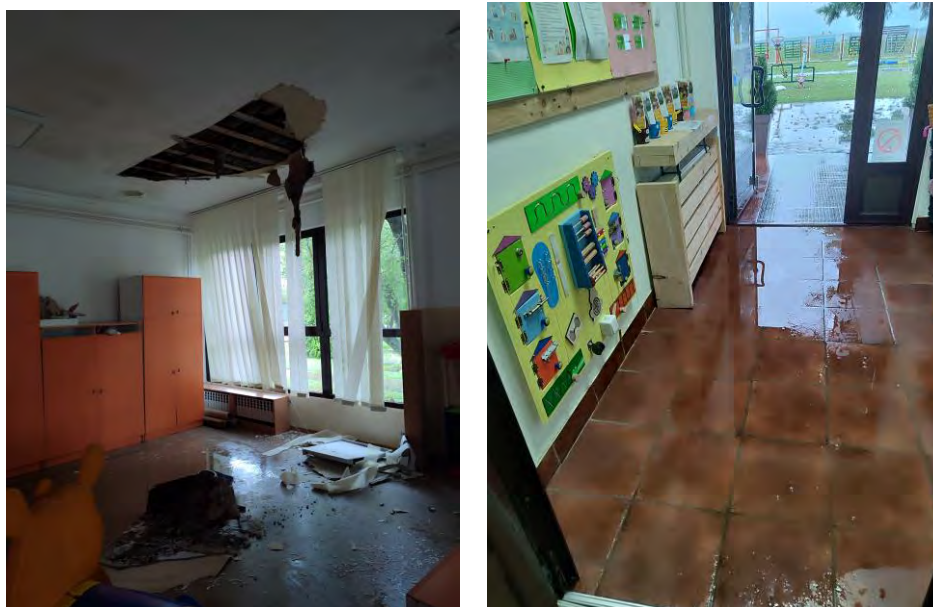
Слика 42. Оштећење објекта
